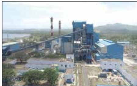
아우랑 화력발전소 (보유지분98%, EPC수행)
